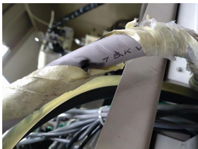
図 2 高圧ケーブルの破損
